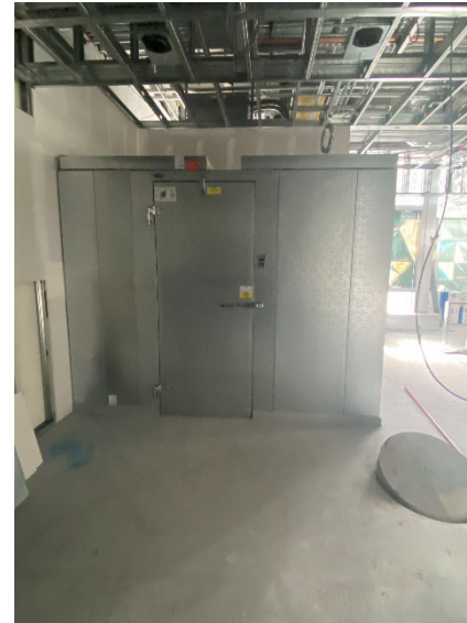
Via Vai ; walk-in cooler installed
